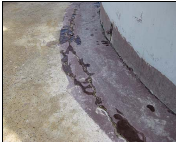
Abb. 4: Bruch des Betonfundamentes
