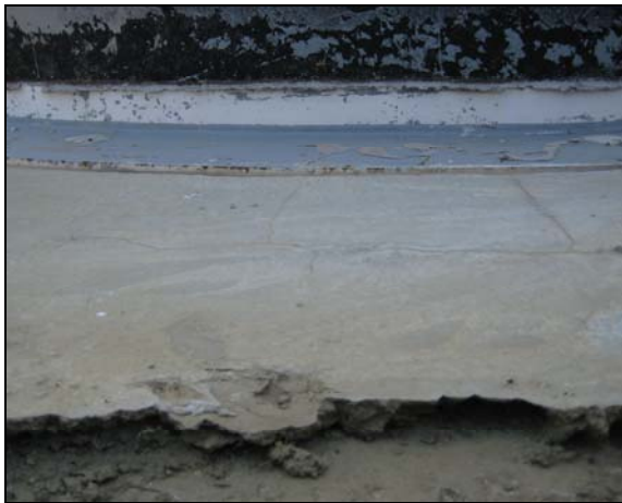
Abb. 3: Abplatzungen des Betons
