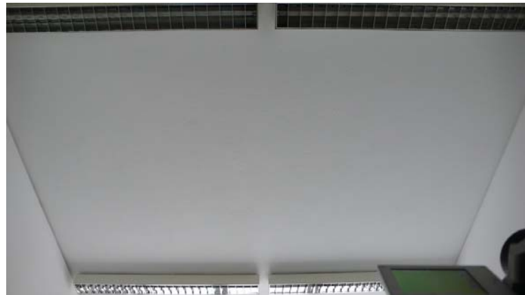
Abbildung 4: äußerlich intakte Raumdecke mit kastenförmigen Deckenlampen
