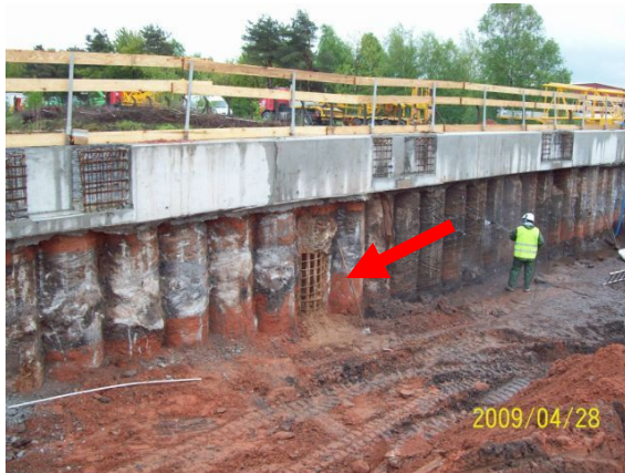
Abbildung 2: Überschnittene Pfahlwand mit Fehler an einer Kraftwerksbaustelle der Siemens Energy in Frankreich.
