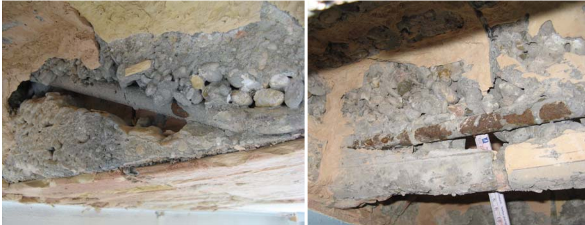
Bilder 4 und 5: Typische Fehlstellen in den Rippenstegen [3]
